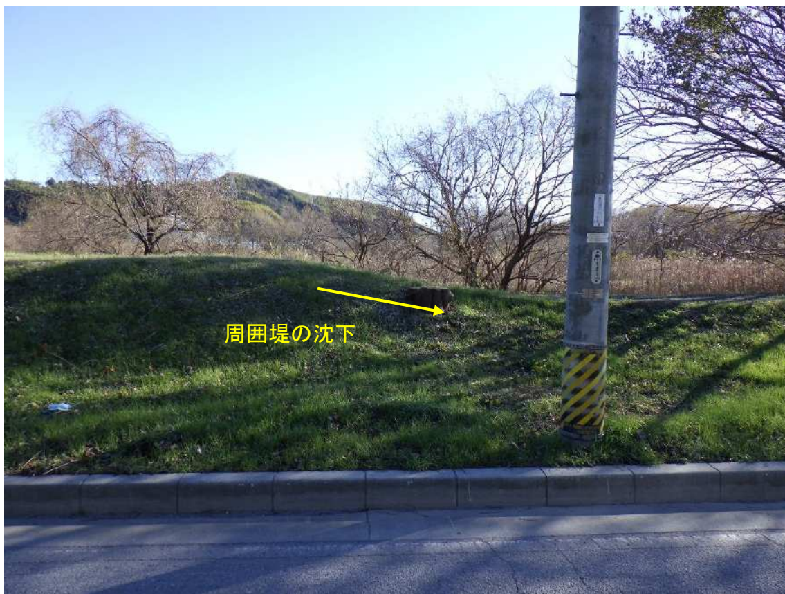
写真3：堤防が沈下している区間（参考）
