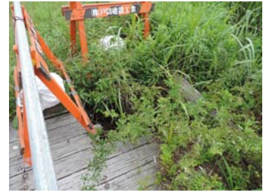
老朽化して腐食した橋
